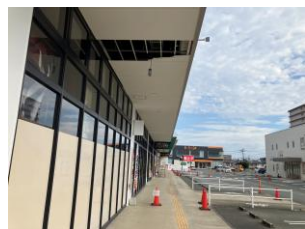
天井材の落下
