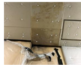
天井・壁面からの雨漏り
